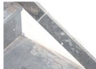
Foto 16. Detalj skiferfliser på trapp og sokkellist Et område manglet skifer og avvalerte lim som rent ned i fugen.
