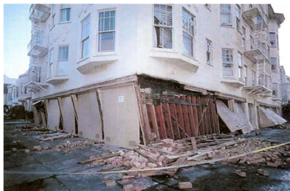
Figur 1b. Eksempel på "soft story" sammenbrudd
