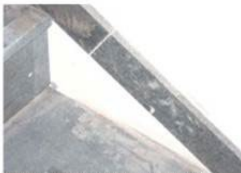
Foto 16. Detalj skiferfliser på trapp og sokkellist Et område manglet skifer og avslørte lim som rent ned i fugen.
