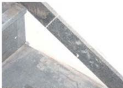
Foto 16. Detalj skiferfliser på trapp og sokkellist Et område manglet skifer og avslørte lim som rent ned i fugen.
